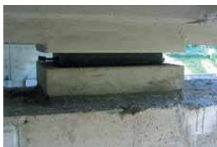
Mostní ložisko po instalaci
