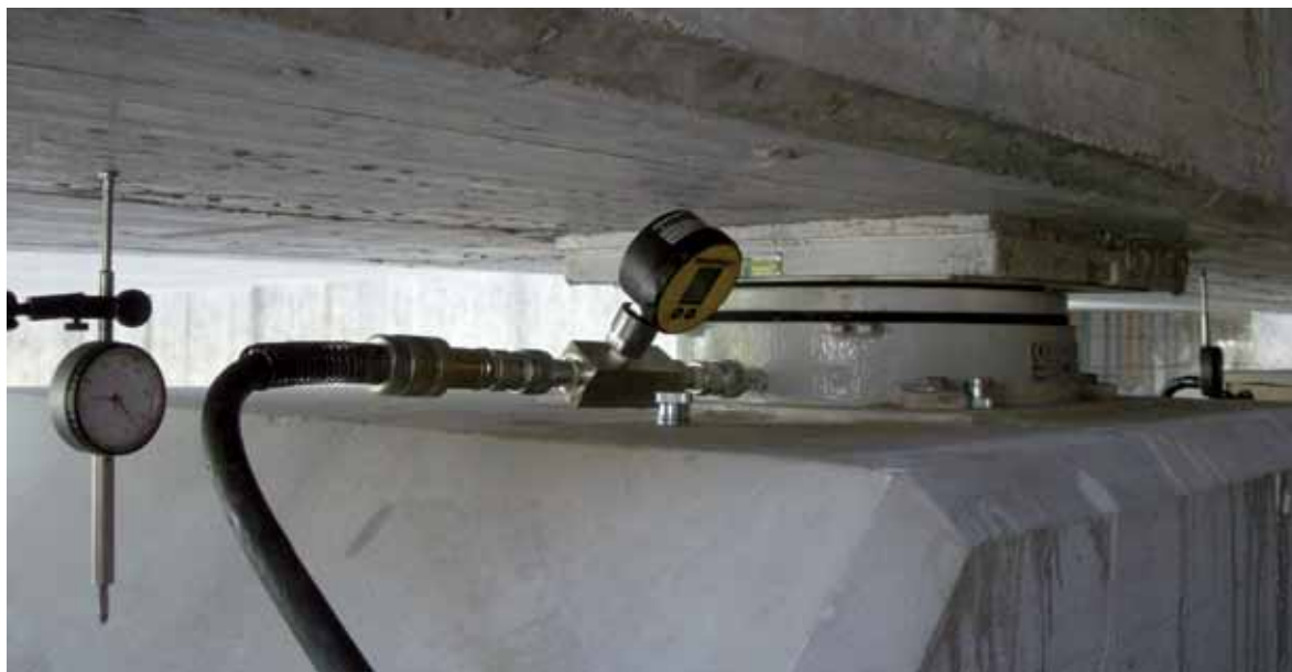
Viadukt Prébois - Švýcarsko: hrncové ložisko s možností monitoringu síly
